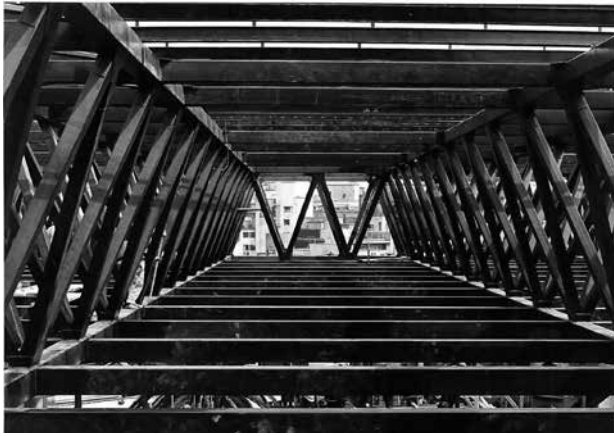
FIG 7 Edificio UNCTAD III. Estructura estereométrica de techo. / Stereometric roof structure. Fuente / Source: Archivo personal de Sergio González.
