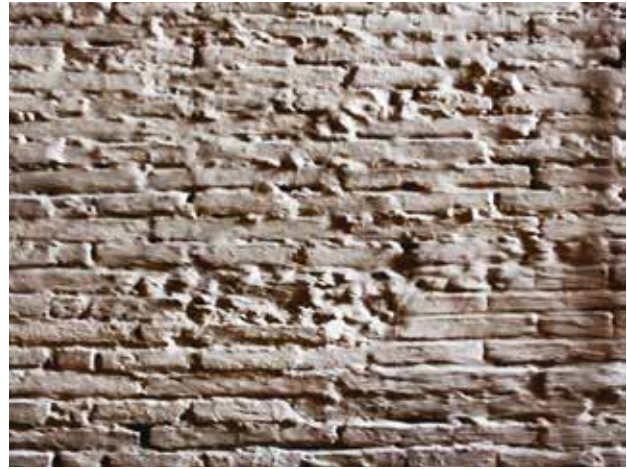
FIG 4b Detalle albañilería de ladrillo de las naves laterales, de construcción posterior / Masonry brick detail in side aisles, of later construction. Fuente / Source: FONDECYT N° 11130628
