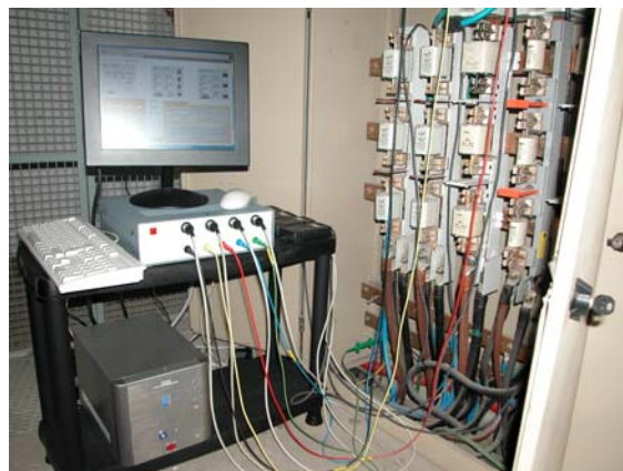
Fig. 2: Sistema de monitorización instalado.
