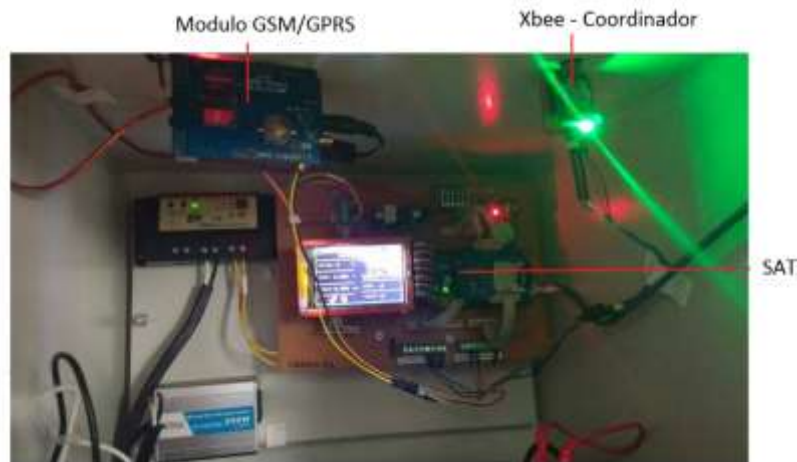
Fig. 10: Tablero electrónico del sistema de adquisición de señales móvil (Datalogger)
