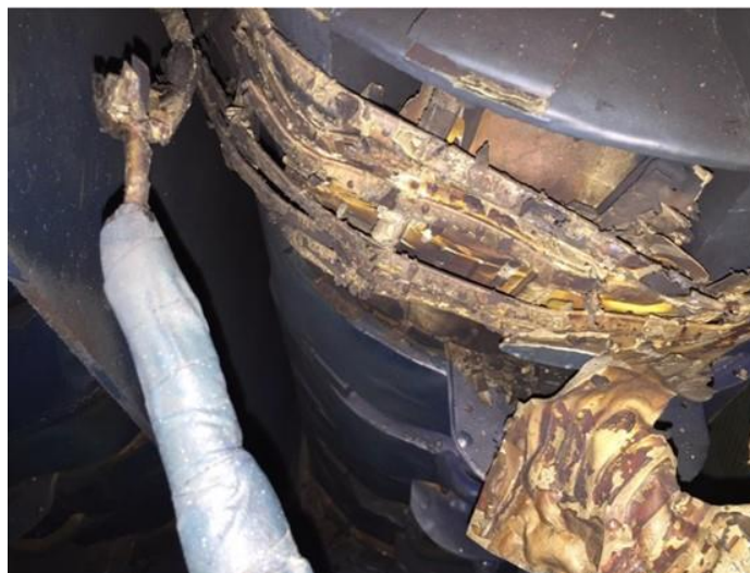
Fig. 9 Falla en un autotransformador ocasionada por una sobre tensión durante la interrupción del proceso de arranque
