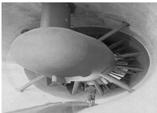
Figura 11. Detalhes da turbina bulbo instalada na usina maremotriz de La Rance, França [7].
