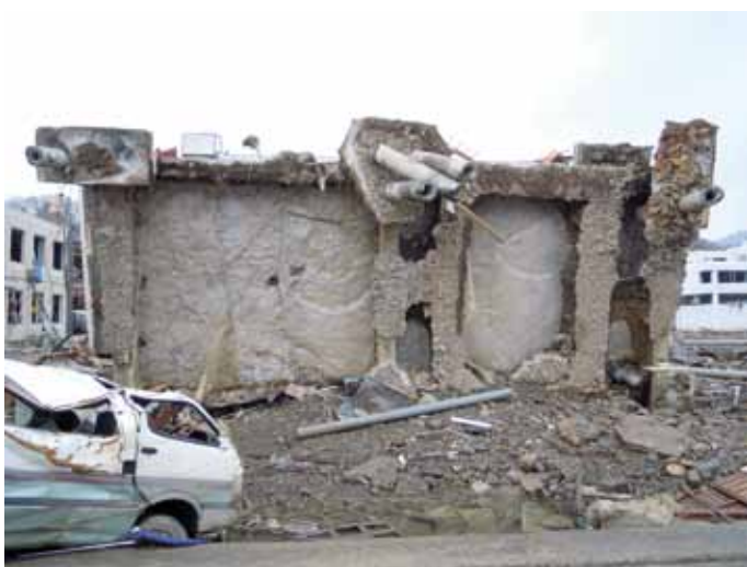
Figura 2: Edificio de hormigón armado fundado sobre pilotes volcado por el tsunami en Onagawa
