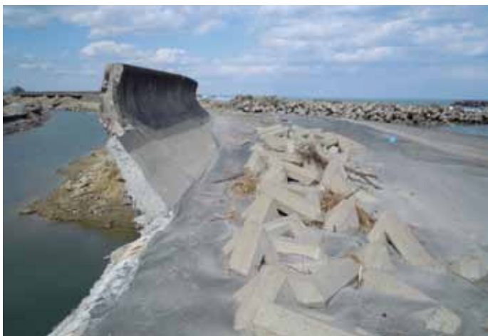
Figura 5: Ruptura de las estructuras de defensa en Watari. La socavación de la parte posterior del dique deja expuesto el núcleo de arena a la acción del agua, lo cual eventualmente también resultó en la rotura de la parte frontal del dique construida de hormigón.
