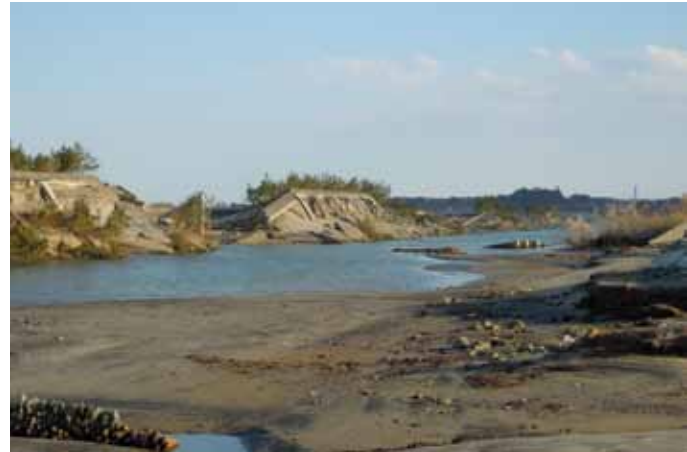
Figura 4: Colapso de una estructura de protección en la ciudad de Soma (Prefectura de Fukushima). Las partes de la estructura que sobrevivieron estaban reforzadas con tetrápodos colocados delante de ellos.
